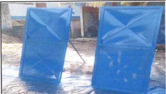
FOTO 3: Sustrucción de puerta (modulo de aula I y modulo aula II)
